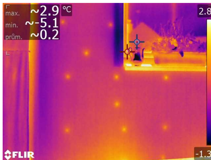
Obr. 6: Tepelný most, kotvení tepelného izolantu Zdroj: (autor, 2024)
