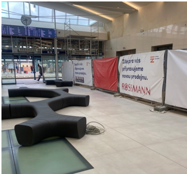
Obrázek 10: Lavice a neoznačené kabely vyčnívající z podlahy
